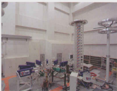
高電圧実験室
